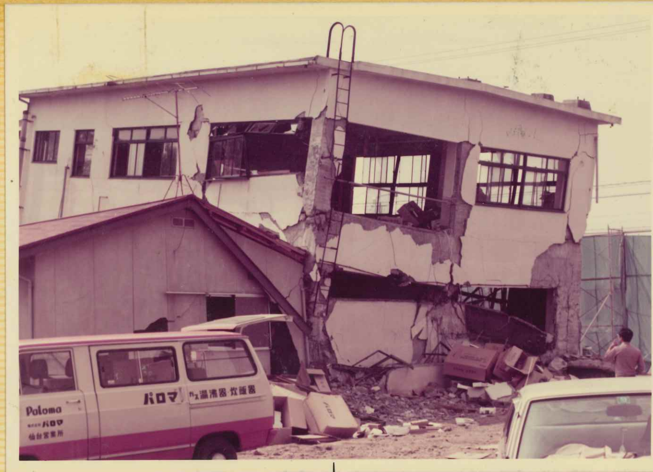
鉄筋コンクリート造 建物の崩壊 (パロマショールーム) その1.
