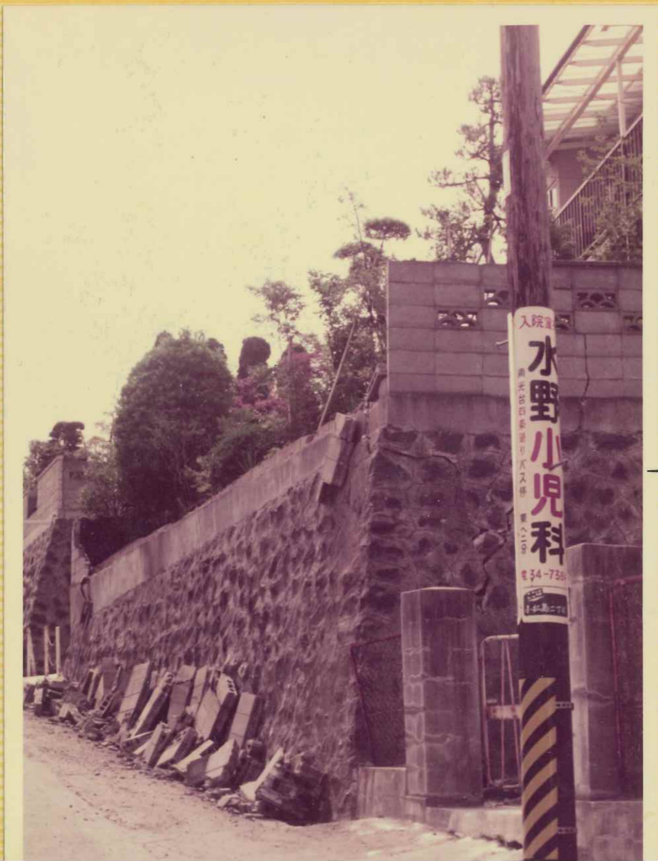
▷ 石積擁壁剥脱と ブロック土留の倒壊 落下.
